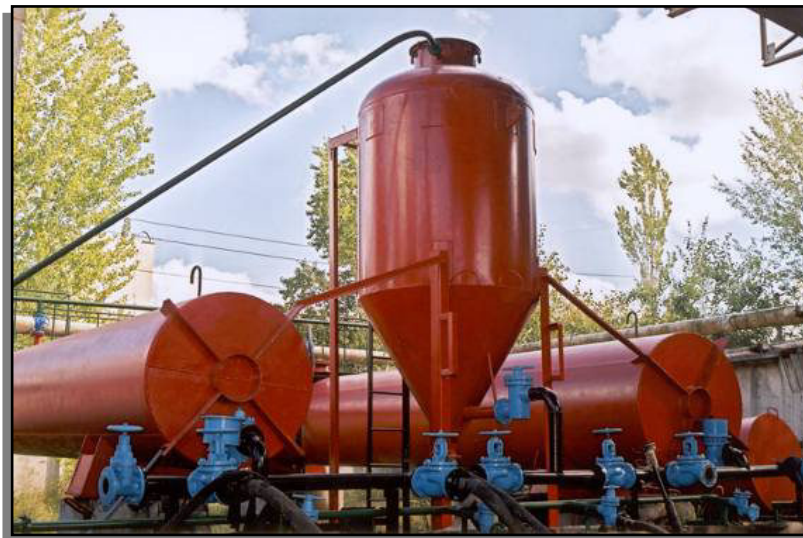
Маслохозяйство для испытания оборудования
